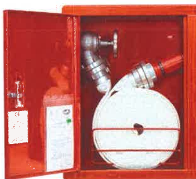
Figura 1 Hidrant inkaso në mur
